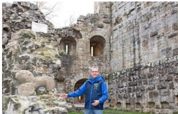
Die Bruchsteinmauer bereitet Sorgen. Sie wird saniert, so Stefan Weber.
